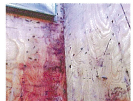
外壁内部の雨漏りの跡 (修補工事のため外壁をはがした状態)
