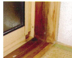
室内への雨漏り
