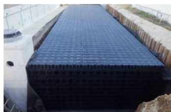
地下型貯留浸透槽
